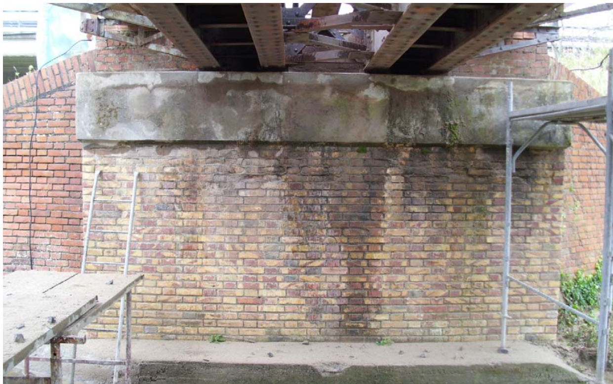
Figura 7 – Vista dell'umidità sulla spalla lato Cecina
