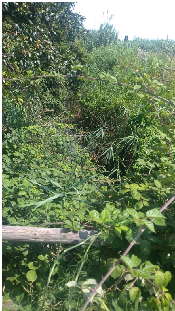
Fot.46: Condizioni di manutenzione dell'alveo del fosso
